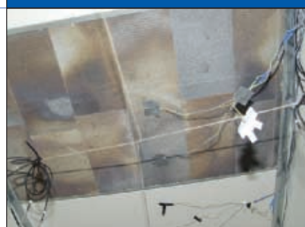
Abb 3: Metallschaumkühldecke im Messraum
